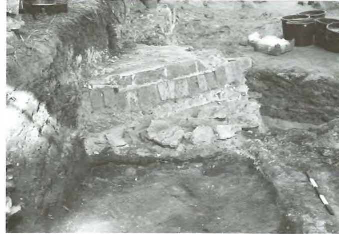
Abb. 6 Pfeilerfundament mit deutlichem Senkungsschaden.
